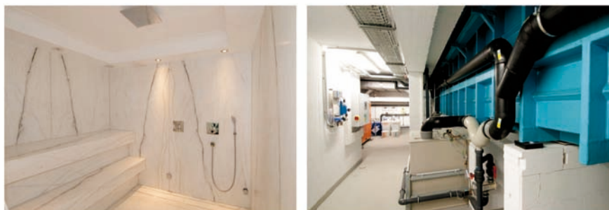
Auch eine Dusche und ein Dampfbad gehören zur Ausstattung. Das Schwimmbecken steht aufgeständert im Untergeschoss der Schwimmhalle. Im großzügig bemessenen Beckenumgang sind die Ospa-Schwimmbadtechnik, der Schwallwasserbehälter und die Entfeuchtungs- und Klimaanlage untergebracht.
